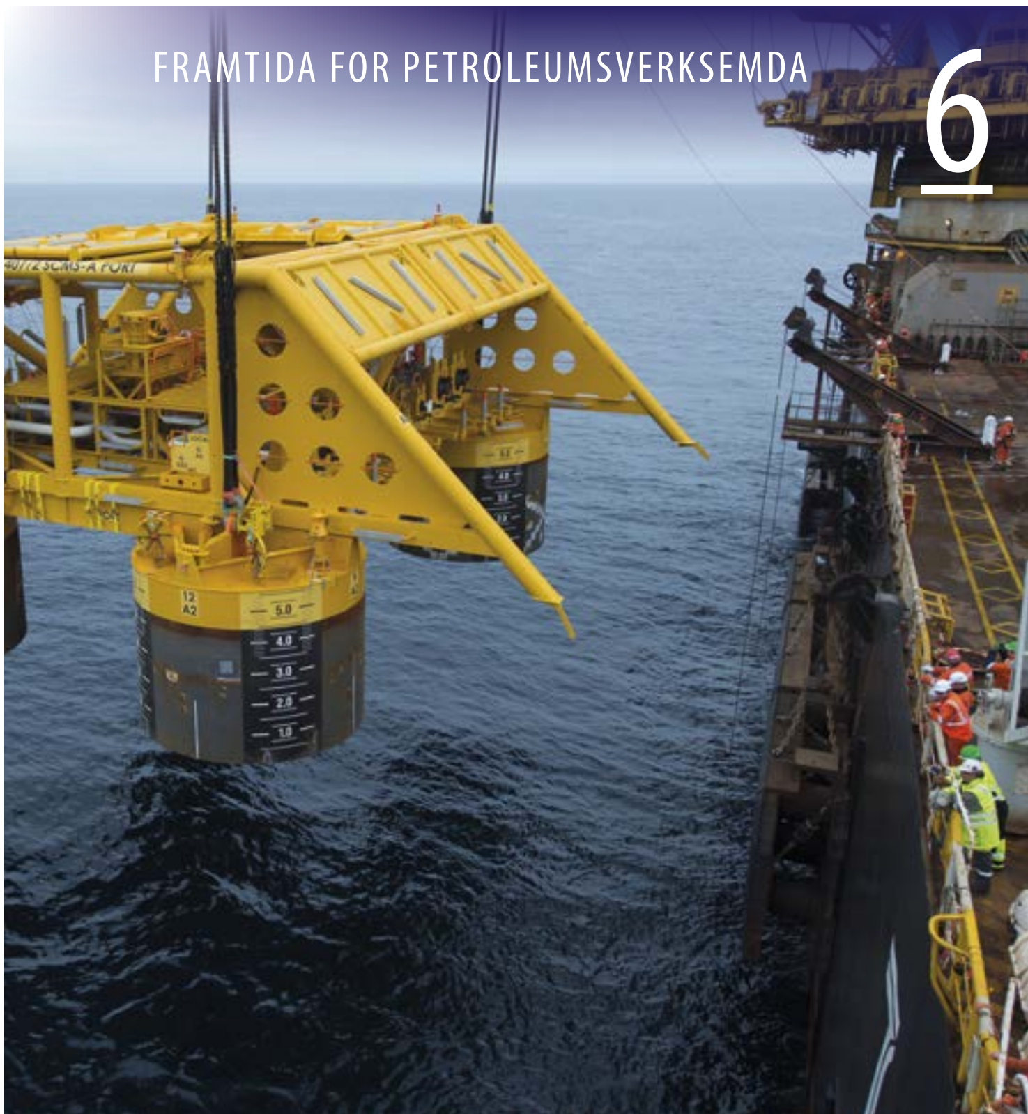
Installering av utstyr for havbotnkompresjon på Åsgardfeltet i Norskehavet. Dette er nyskapande teknologi som vil føre til vesentleg auke i gass- og kondensatproduksjonen på feltet (Foto: Øyvind Hagen, Statoil)
