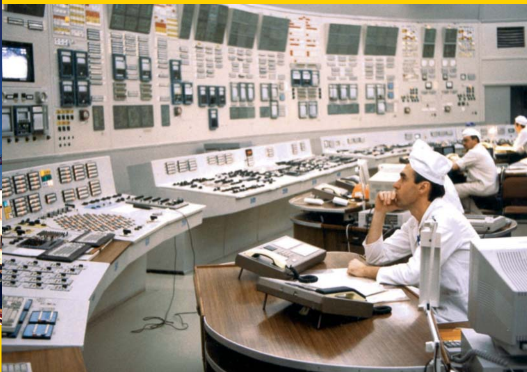
I kontrollrommet ved Leningrad kjernerkraftverk overvåkes driften av kraftverket. Foto: Statens Strålevern.
