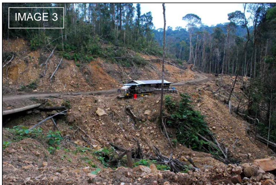
Figur 17: Flatehogst i større bredde enn tillatt; ingen kantsone langs bekken til venstre (bekken er like utenfor bildet i skråningen i forgrunnen) Opphopning av hogstavfall i bekken er synlig nederst på bildet. Se Figur 12 for beliggenhet.
