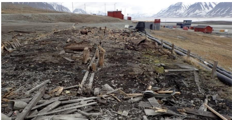
Alle bygg i Svea sentrum er revet bortsett fra de som er fredet. Foto: Sysselmesteren på Svalbard.
