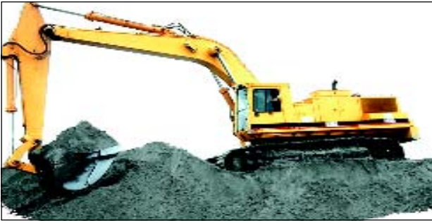
Figur 7.13 Forurensinger i grunnen utgjør et miljøproblem mange steder i landet.
