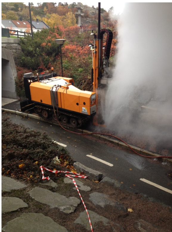
Figur 3.20 Skade på fjernvarmeanlegg i Kristiansand pga. bruk av georigg
