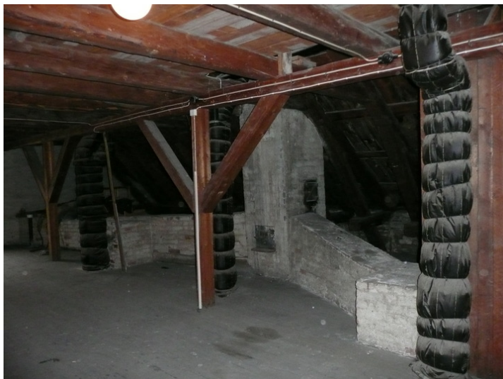
Cellefløy. Loft. Deler av ovn- og pipesystem. Opphavsrett: Statsbygg.
