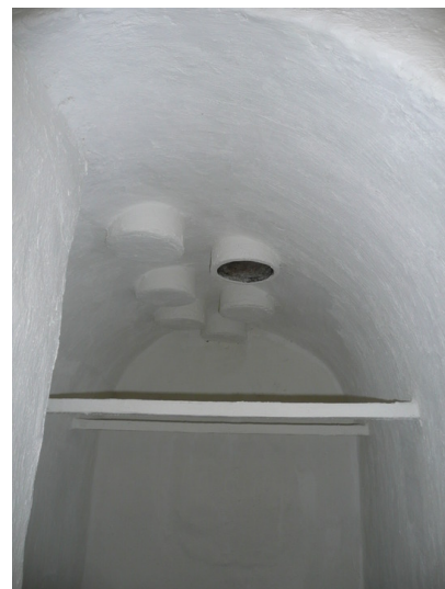
Cellefløy. Kjeller. Rør til oppvarmingssystem. Opphavsrett: Statsbygg.
