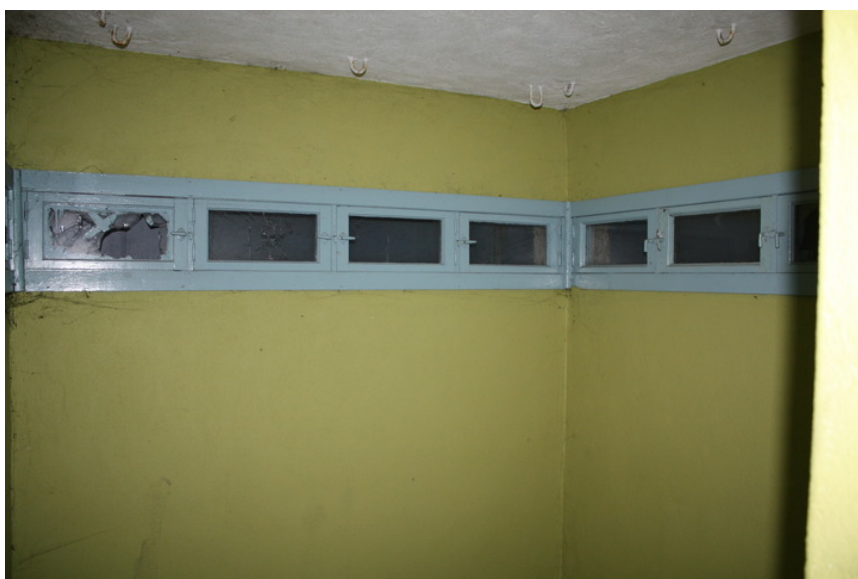
Sett fra døra mot sørvest. Foto: Tore Pettersen, DSB.
