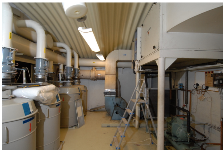
Ventilasjonsanlegg med filtre. Foto: Leif Anker, Forsvarsbygg.
