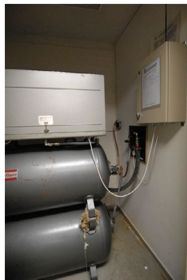
Kompressorrom. Foto: Leif Anker, Forsvarsbygg.
