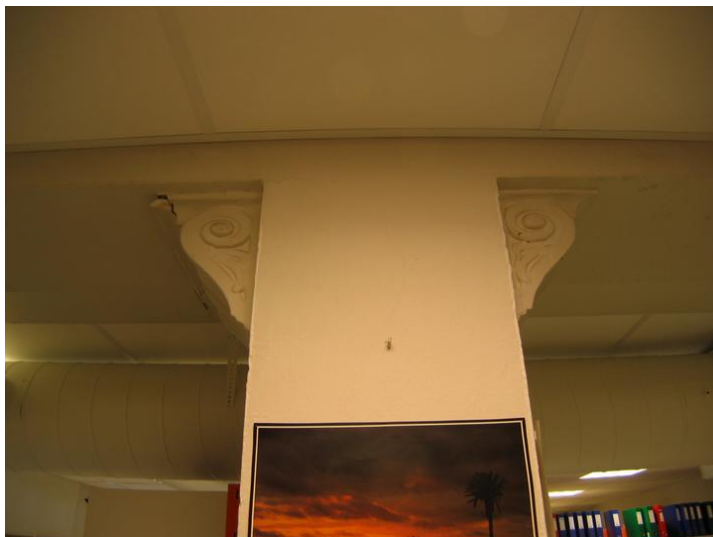
Gipsornamenter, dessverre i dårlig stand. Opphavsrett: Statsbygg.
