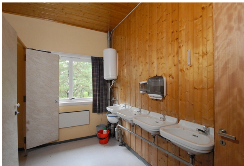
Toalett, interiør. Foto: Leif Anker, Forsvarsbygg
