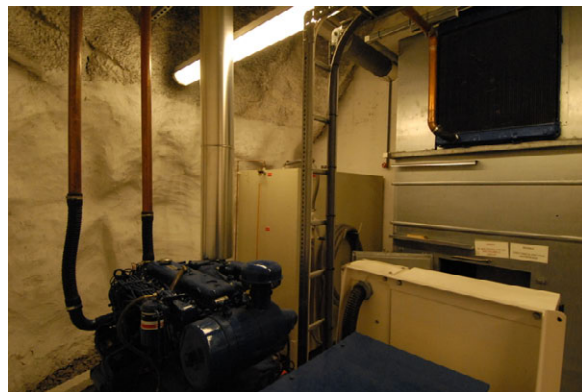
Aggregatrommet ved vestibyen. Foto: Leif Anker.
