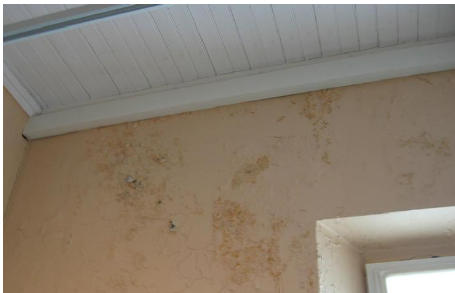
Fukt i ytterveggene Opphavsrett: Statsbygg.
