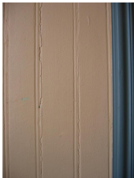
Uheldig bruk av latexmaling på innervegger Opphavsrett: Statsbygg.
