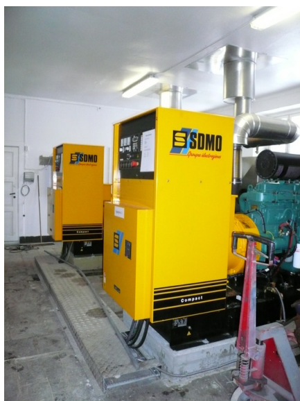
Nåværende generatorer i Kraftstasjonen. Opphavsrett: Statsbygg.
