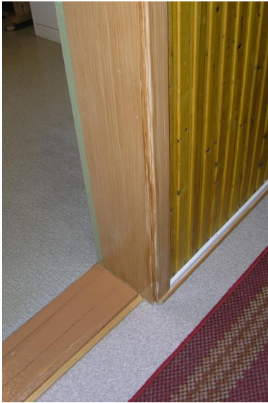
Ådret dørkarm. Opphavsrett: Statsbygg.
