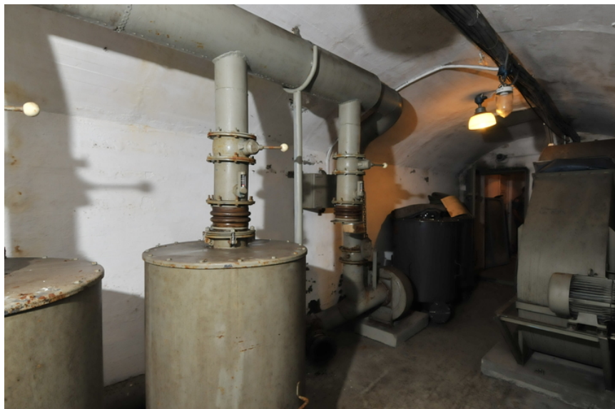
Ventilasjonsrom med ABC-filtre. Foto: Leif Anker, Forsvarsbygg
