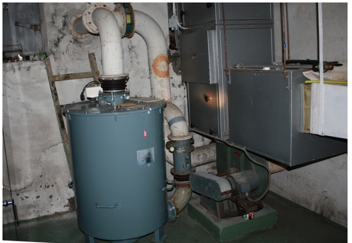
Ventilasjonsrom. Foto: Tore Pettersen, DSB.
