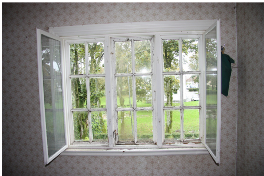
Eldre vindu på soverom i 2. et. Opphavsrett: Statsbygg.
