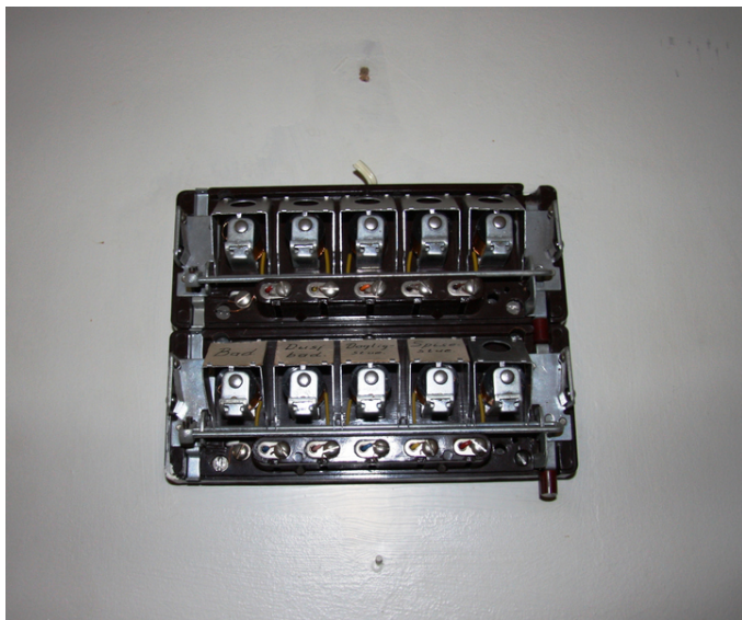
Ringklokkesystem i direktørboligen. Opphavsrett: Statsbygg.
