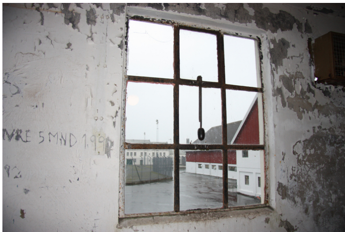
Eldre støpejernsvindu i silotårnet. Opphavsrett: Statsbygg.
