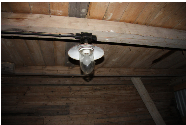
Taklampe i redskapsskuret. Opphavsrett: Statsbygg.
