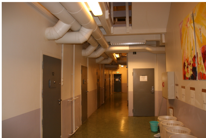
Cellefløyen, 1. etasje. Nye dører og nytt ventilasjonsanlegg er godt synlig. Opphavsrett: Statsbygg.
