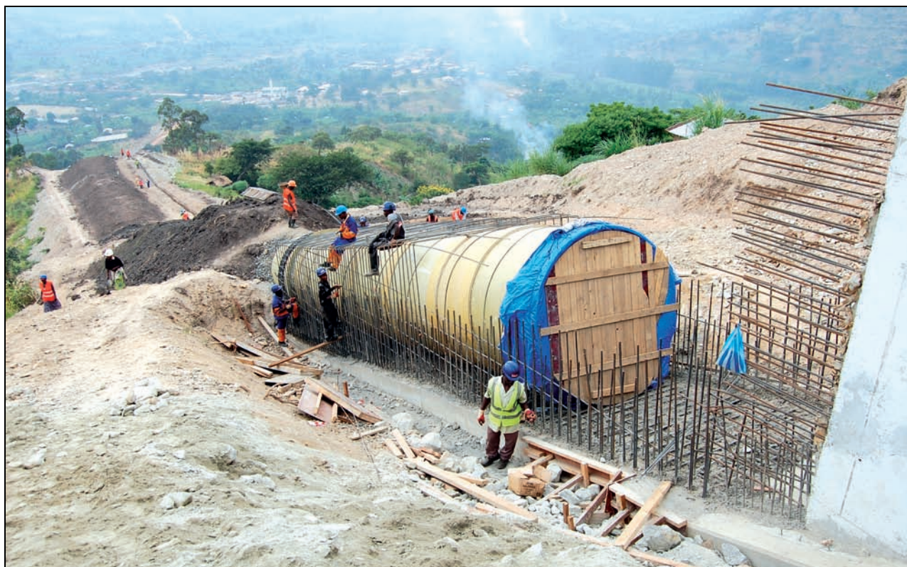
Figur 3.4 Bugoye vannkraftverk i Uganda
