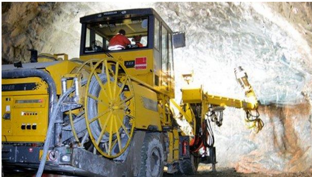
Figur 3-2 Borerigg som borer for neste salve i tunnel. Foto: Geir Brekke, Statens vegvesen.
