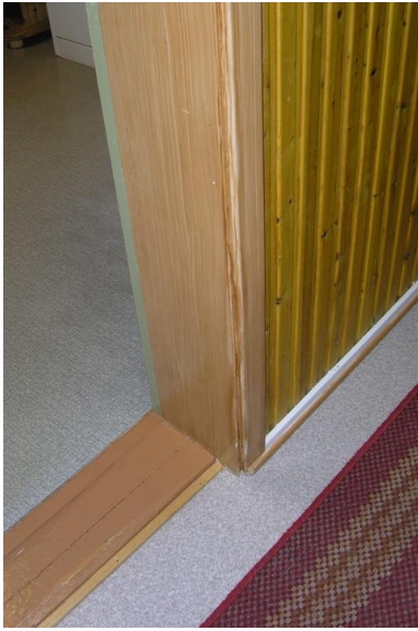
Ådret dørkarm. Opphavsrett: Statsbygg.
