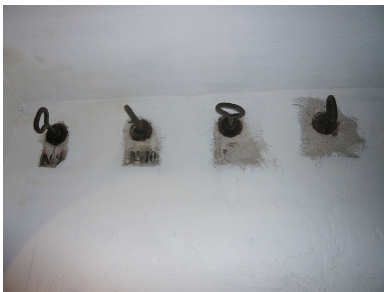
Spjel til hver celle. Del av opprinnelig oppvarmingssystem. Opphavsrett: Statsbygg.
