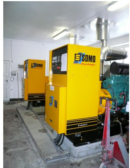
Nåværende generatorer i kraftstasjonen. Opphavsrett: Statsbygg.
