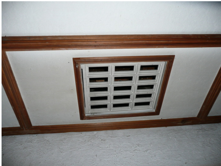
Ventilasjonsluke i taket i casinoet. Opphavsrett: Statsbygg.
