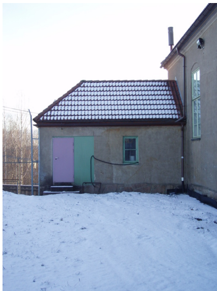
Aggregatbygning vestsiden. Opphavsrett: Statsbygg.
