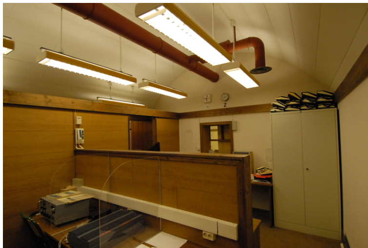
Fra sambandsrommet. Foto: Leif Anker.
