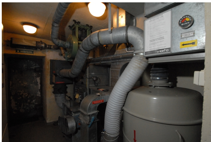
Ventilasjonsrommet med tønne for ABC-filter i forgrunnen. Foto: Leif Anker.
