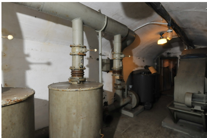
Ventilasjonsrom med ABC-filtre. Foto: Leif Anker, Forsvarsbygg
