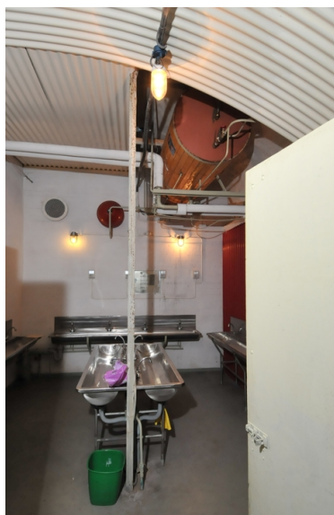
Vaskerom og toaletter. Foto: Leif Anker, Forsvarsbygg
