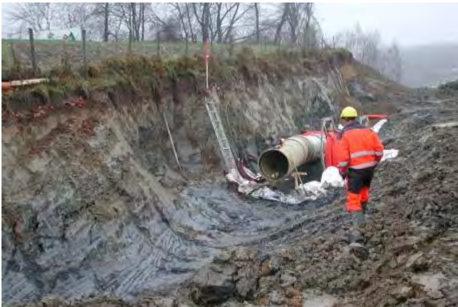
Figur 6.14 Ved terrenginngrep som ved graving av vannledning gjennom jordbruksområde (Lier), er det viktig å gjennombygge jorda med opprinnelig lagrekkefølge for å bevare produktiviteten (Haraldsen, 2013).
