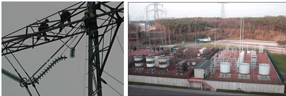
Figur 7-1 Spenningsoppgradering (bilde fra Statnett) og SVC-anlegg (bilde fra ABB)
