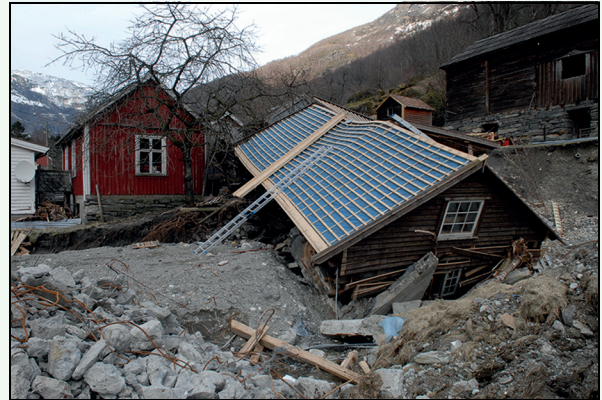
Figur 9.13 Flom og ras er akutte trusler som kan skade kulturmiljø.
