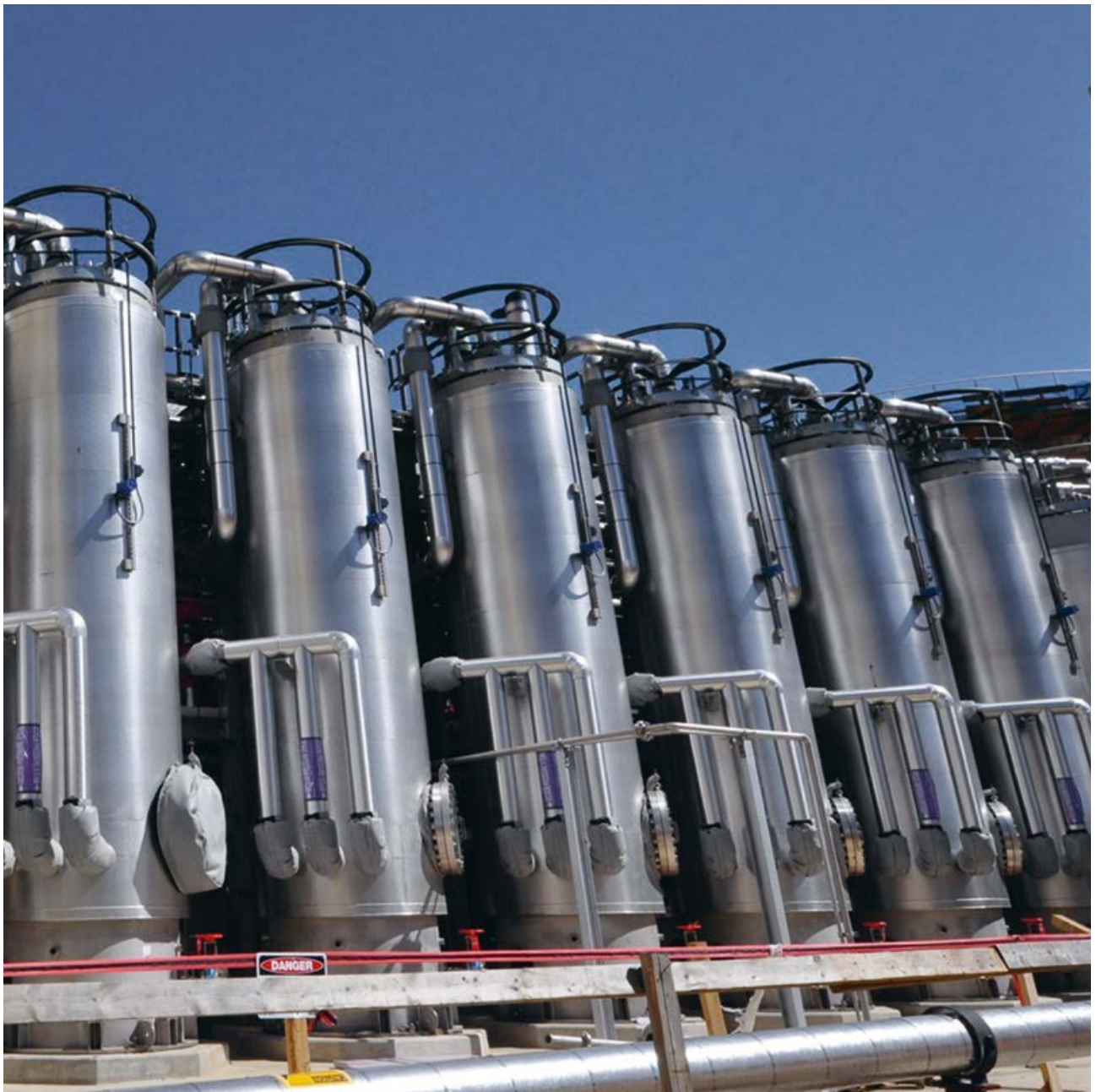
Verdens største Cambi-anlegg for produksjon av biogass fra slam og avfall, Washington DC. Foto: www.cambi.com .
