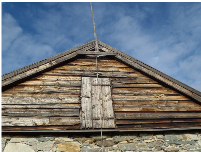
Gavlen er kledd med liggende panel. Luke til loftsrom. Foto: M.Oftedal, Forsvarsbygg.
